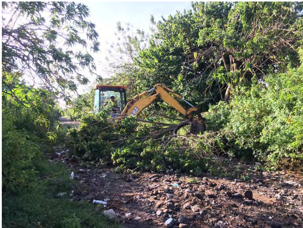
Renta de maquinaria para la rehabilitación de la calle Coyula, en la comunidad de San Jerónimo Coyula, Atlixco, Puebla.
