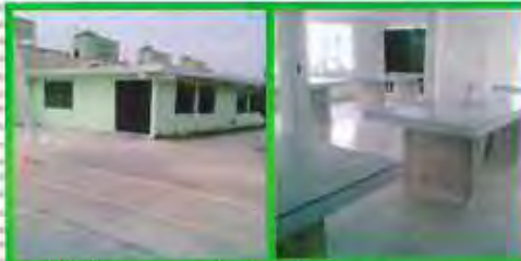
Habilitación del laboratorio escolar con azulejo, pintura, vidrios e instalación eléctrica, así como, la rotulación de la escuela "Jose Vasconcelos" en la unidad habitacional San Buenaventura
