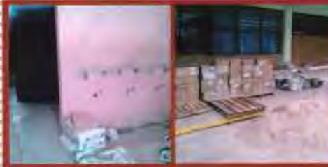
Rehabilitación de los baños de hombres y mujeres del primer piso de la Esc. Sec Telésforo Roldán Yáñez, que tenían 16 años sin uso, por deterioro.
