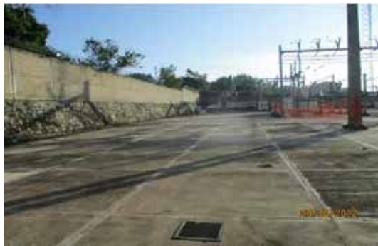
Ilustración 8. Paso vehicular en la S. E. Frontera Comalapa
