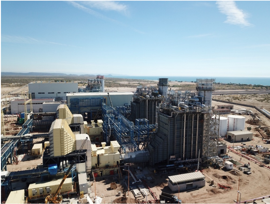
Imagen 2: Central Ciclo Combinado Empalme II
