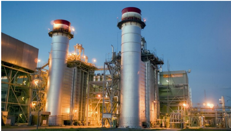
Imagen 1: Central Ciclo Combinado Agua Prieta II
