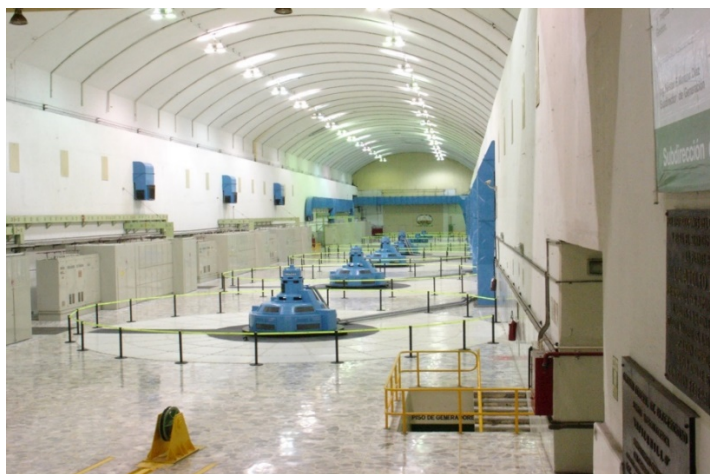
Imagen 5: Central Hidroeléctrica Infiernillo
