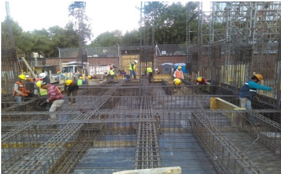
Fotografía: SE Morales Bancos 1 y 2 (SF6) + MVAR
