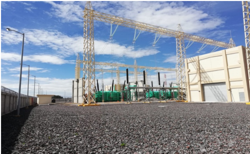
Fotografía: SE Lago Bancos 1 y 2
