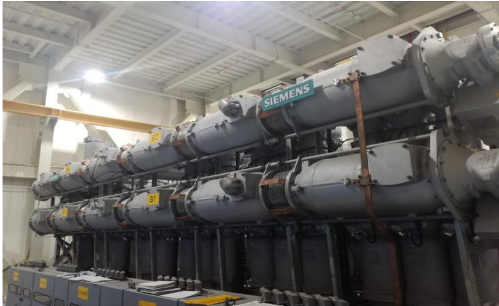
Fotografía: SE Condesa Banco 1 SF6 (Sustitución) + MVar
