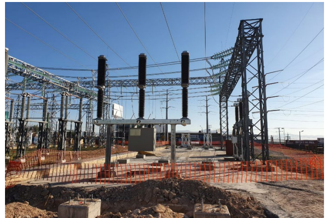
S.E. León III MVAR / 348 SE 2101 Compensación Capacitiva baía – Occidental
