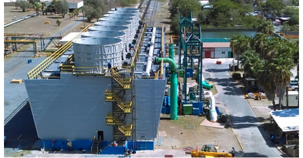
Torre de Enfriamiento U3 CT Emilio Portes Gil
