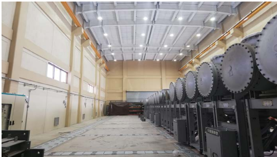
S.E. Lago / 266 SLT 1603 Subestación Lago
