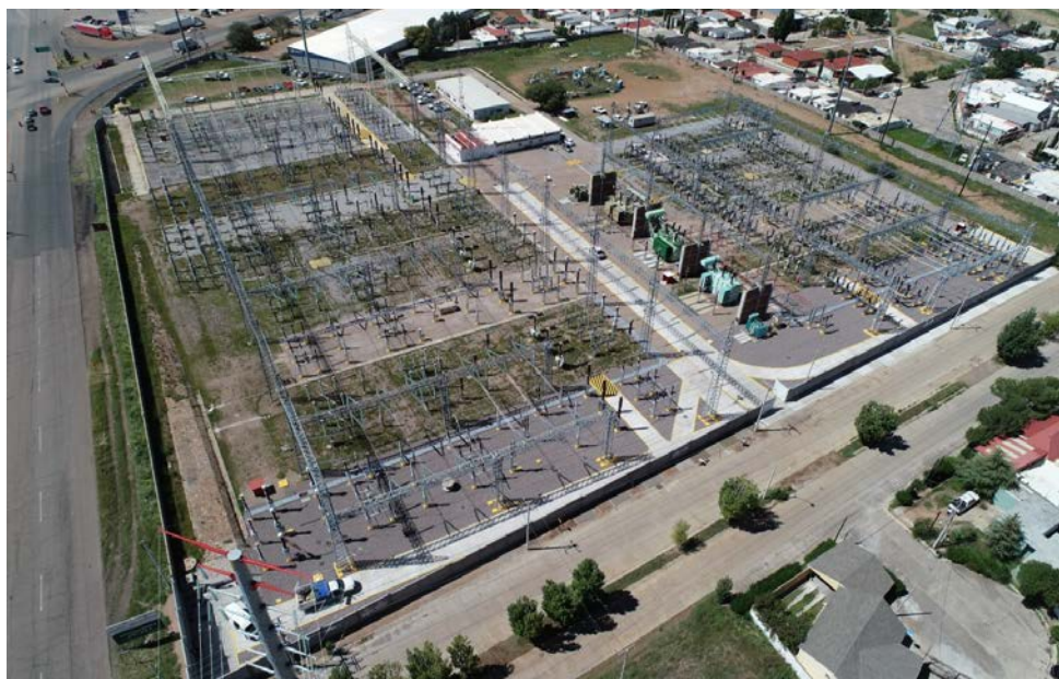
S.E. Cuauhtemoc II Ampliación Banco 3 / 337 SLT 2002 Subestaciones y Líneas de las Áreas Norte - Occidental (2a Fase)
