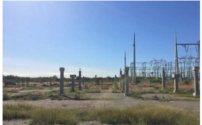
S.E. Guémez Ampliación / 304 LT Red de Transmisión Huasteca – Monterrey
