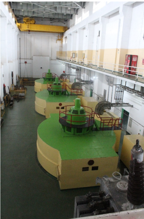
Modernización Sistema Control CH Falcón
