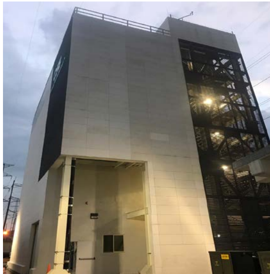
S.E. Lago de Guadalupe Bcos. 1 y 2 + MVAr / 309 SLT 1820 Divisiones de Distribución del Valle de México
