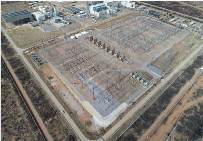
S.E. Silao Potencia Bco. 3 / 337 SLT 2002 Subestaciones y Líneas de las Áreas Norte – Occidental” (1ª Fase).
