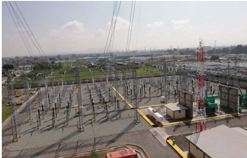
S.E. Caracol Bancos 1 y 2 + MVAr / 282 SLT 1720 Distribución Valle de México 1a Fase
