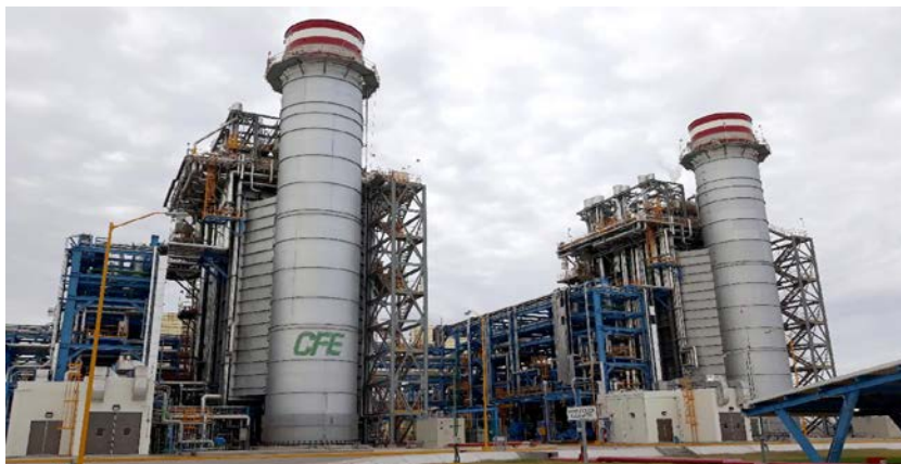
Central de Ciclo Combinado Empalme I
