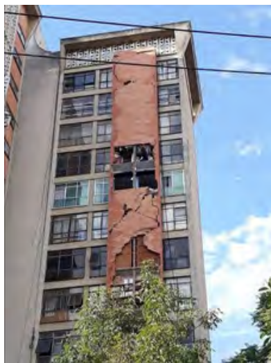
Imagen 11. Después del 19S el inmueble resultó afectado, inhabitable.
