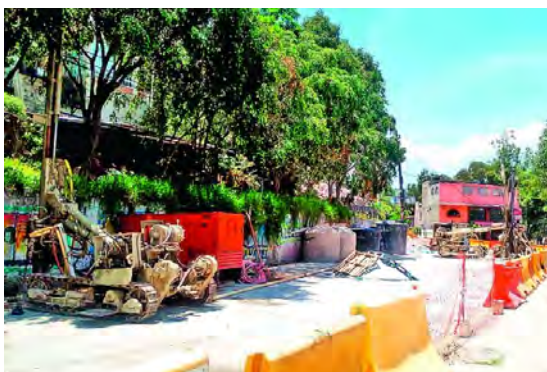
Imagen 16. Equipos de perforación para la ejecución del mejoramiento de suelos en la Carretera Xochimilco-Tulyehualco. Fuente: twitter @SOBSECDMX
