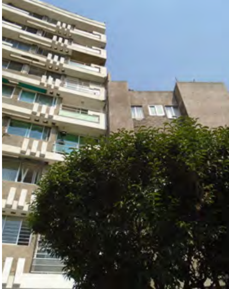
Imagen 21. Después del 19S, el edificio se "recargó" hacia la derecha, en el inmueble vecino
