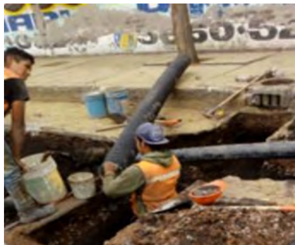
Imagen 28. Sustitución de tuberías para descargas domiciliarias. Fuente: Informe de la Delegación Tláhuac.
